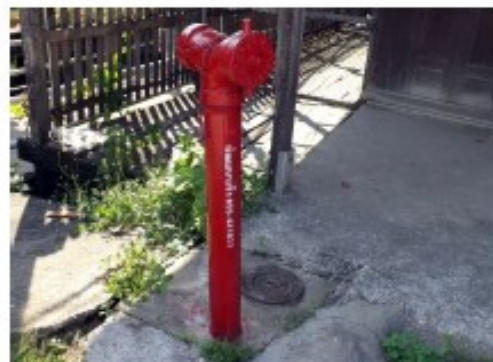
ภาพที่ 63 จุดต่อท่อดับเพลิง
