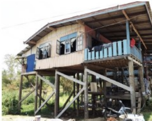
ภาพที่ 72 บ้านติดเสาสูงเสริมเสาค้ำยันเพิ่มความแข็งแรง
