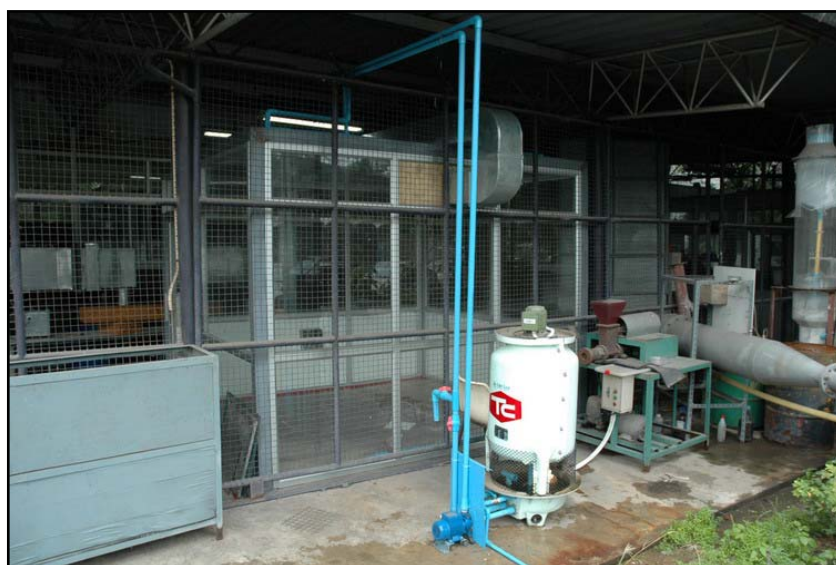
รูปที่ 3.15 การใช้หอผึ่งเย็น Cooling Tower จ่ายน้ำเย็นเข้าสู่แผงเพดานเย็น
