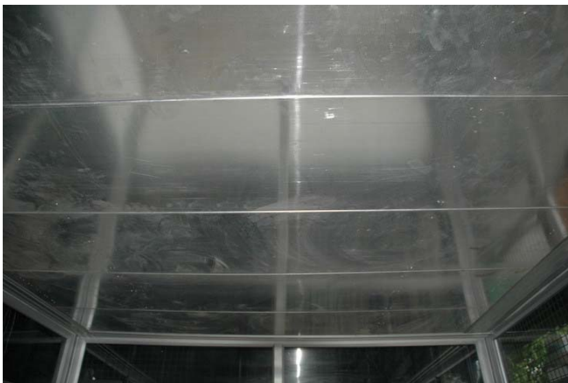
รูปที่ 3.16 ลักษณะแผงเพดานเย็นที่ติดตั้งในห้องทดลอง
