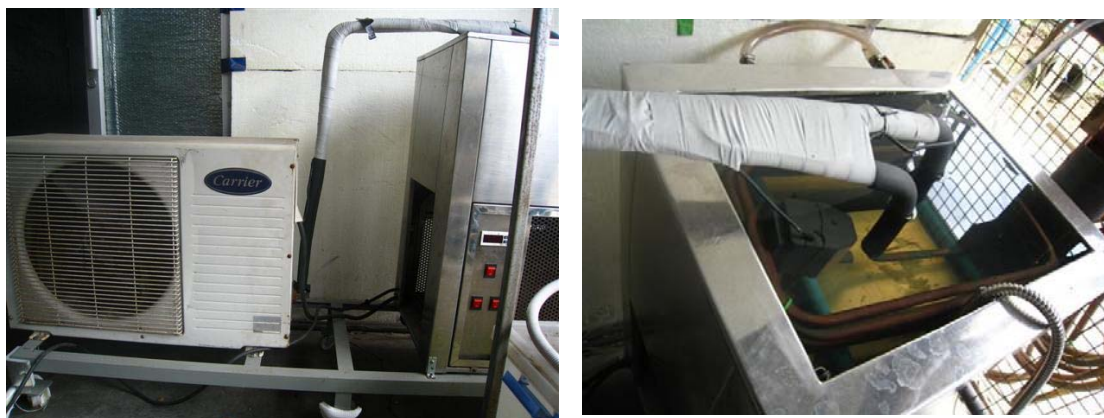
รูปที่ 3.35 ระบบเครื่องทำน้ำเย็น
