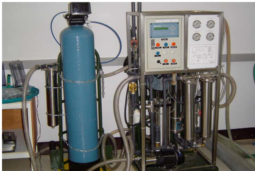
ภาพที่ 3.2 ภาพแสดงระบบเยื่อกรองแบบออสโมซิสผันกลับ
