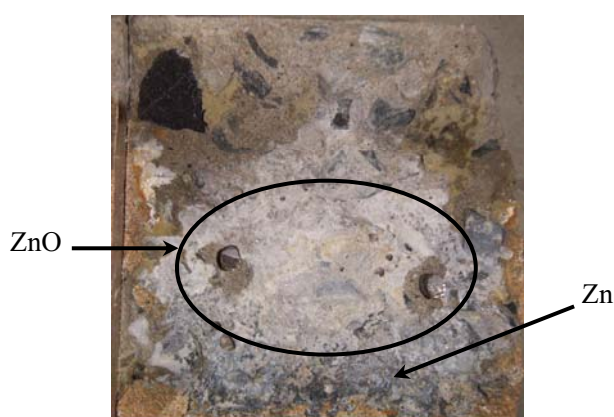
(ข) ภาพตัวอย่างหลังจากผ่านการซ่อมแซมโดยใช้สารละลาย \text{ZnSO}_4 ความเข้มข้น 0.5 โมลต่อลิตร และศักย์ไฟฟ้าภายนอก 3 โวลต์
