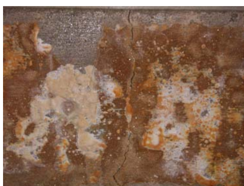
(ข) รอยแตกร้าวหลังการซ่อมแซม
