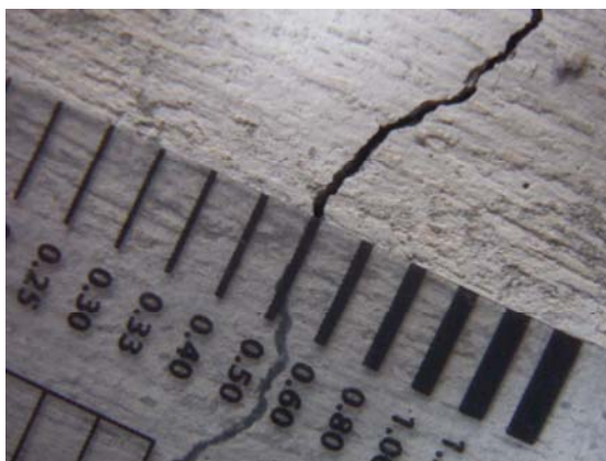
ภาพที่ 11 รอยแตกร้าวของตัวอย่างทดสอบคอนกรีตเสริมเหล็กความกว้างประมาณ 0.5 มิลลิเมตร
