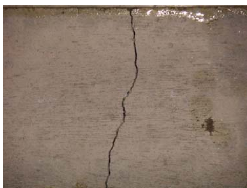
(ก) รอยแตกร้าวก่อนการซ่อมแซม
