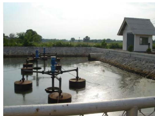
บ่อบำบัดน้ำเสีย
