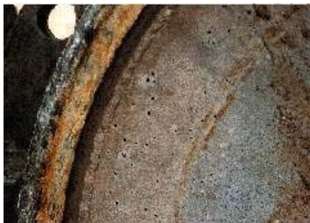
รูปที่ 7.14 การกัดกร่อนแบบหลุมลึก (Pitting Corrosion)
