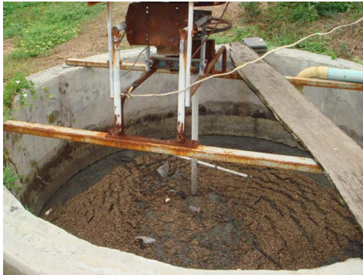
รูปที่ 25 ตำแหน่งเก็บตัวอย่างน้ำเสีย ก่อนเข้าถังแก๊สสำหรับฟาร์มที่ติดตั้งระบบ Biogas system
