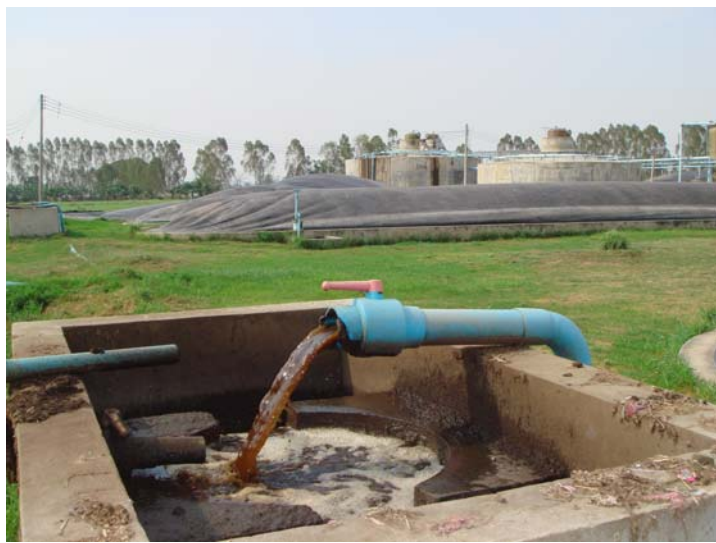
รูปที่ 24 แสดงการปั้มน้ำเสียจากบ่อชักตะกอนกลับเข้าสู่ระบบบำบัด
