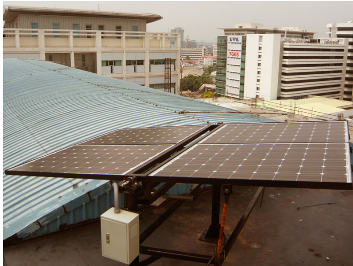
ภาพที่ 3-2 แผงโซลาร์เซลล์ (ติดตั้งบนดาดฟ้าสถาบันนวัตกรรมเทคโนโลยี ไทย-ฝรั่งเศส)
