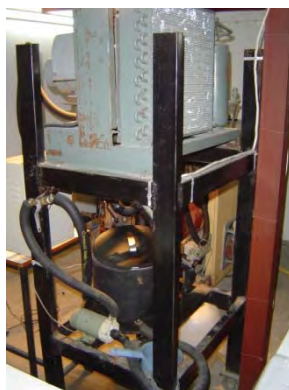
รูปที่ 3.22 อ่างทำความเย็น
