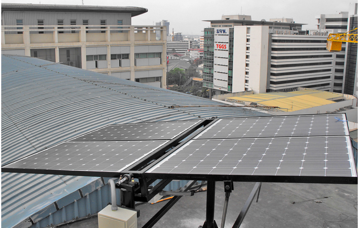
ภาพที่ 3-2 แผงโซลาร์เซลล์ (ติดตั้งบนอาคารพาณิชย์สถาบันนวัตกรรมเทคโนโลยี ไทย-ฝรั่งเศส)
