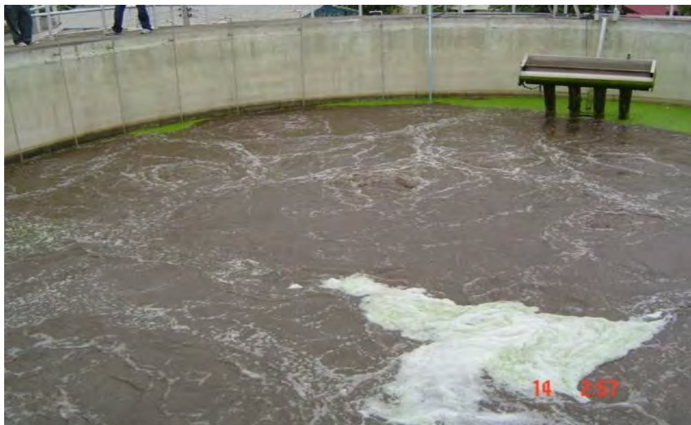
ภาพที่ 14 รูปแบบระบบบำบัดน้ำเสียของโรงงาน WWTP 5
