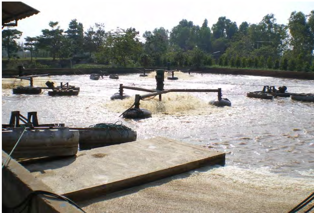
ภาพที่ 8 บำบัดน้ำเสียแบบเติมอากาศของโรงบำบัดWWTP 2
