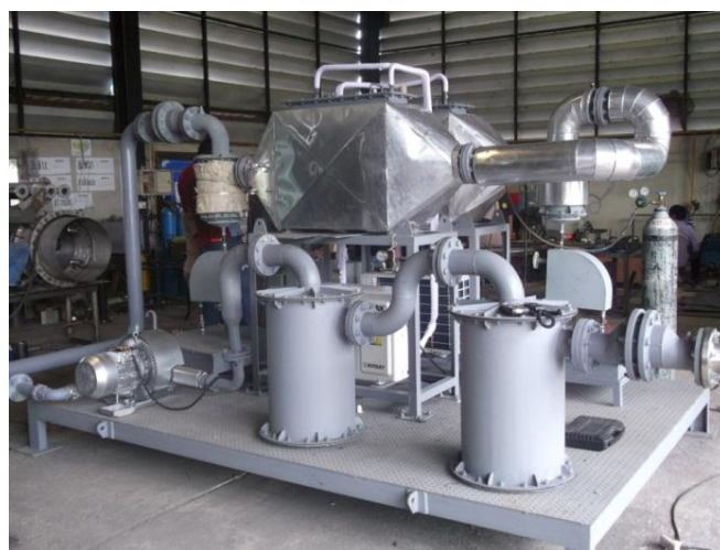
รูปที่ 3 (a) ระบบสกัดไอน้ำทั่วไป ประกอบด้วยบ่อสกัด เครื่องสูบลไอน้ำ และระบบบำบัดไอน้ำปนเปื้อน (b) ระบบสกัดไอน้ำเครื่องแรกของประเทศไทยที่สร้างโดยกรมส่งเสริมคุณภาพสิ่งแวดล้อม โดยมีดร.ธนพล เพ็ญรัตน์ ในฐานะที่ปรึกษาและคณะทำงานวิจัย
