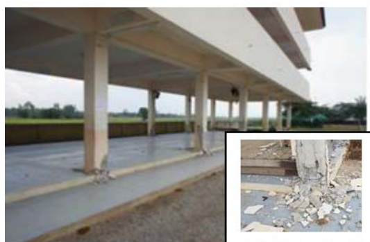
รูปที่ 2.25 อาคาร 2 เสาอาคารแตกร้าวรุนแรง (ปณิธาน ลักคุณะประสิทธิ์, 2557)
