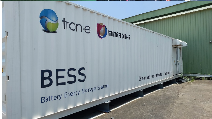
รูปที่ 4 ระบบกักเก็บพลังงานด้วยแบตเตอรี่ (Battery Energy Storage System) ของ Tron-e
