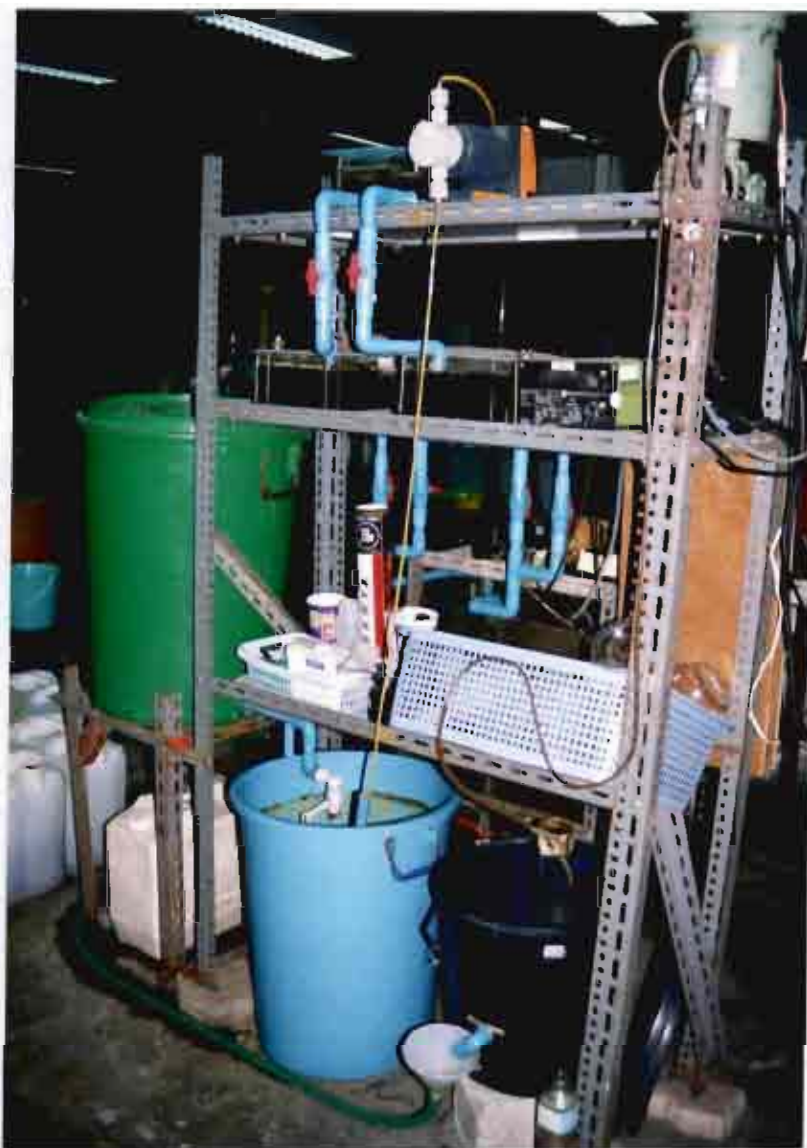
รูปที่ 3-5 ถังเก็บน้ำเสียและถังรองรับน้ำทิ้ง
