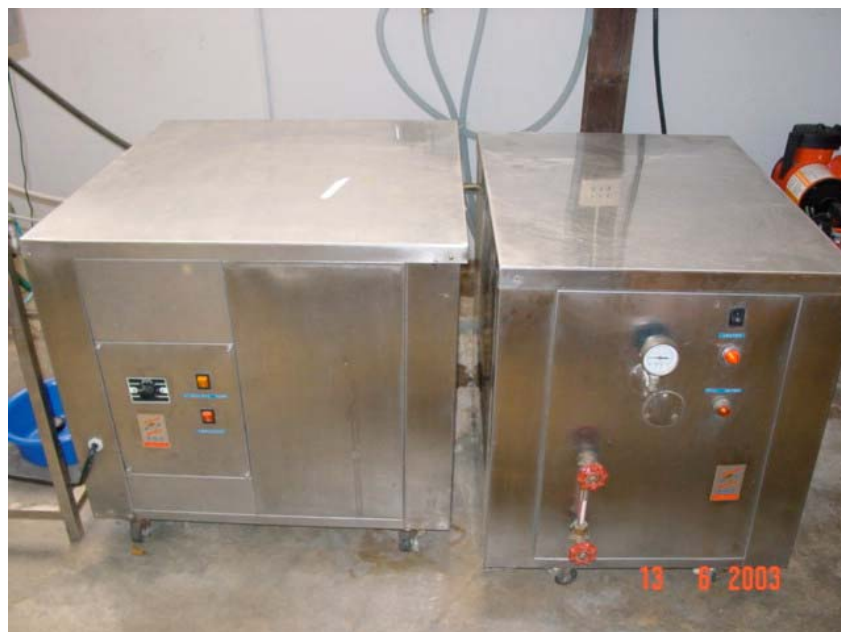
รูปที่ ค.3 เครื่องทำน้ำเย็น (ซ้าย) และเครื่องผลิตไอน้ำ (ขวา)
