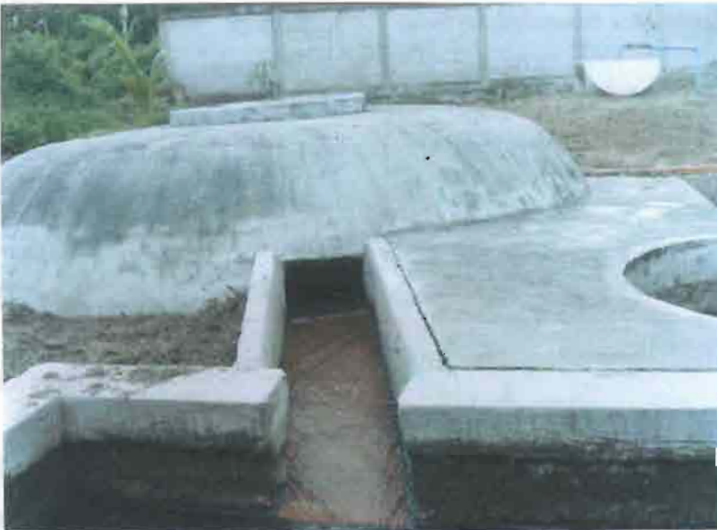
บ่อบำบัดน้ำเสีย (ผลิตก๊าซชีวภาพ)
