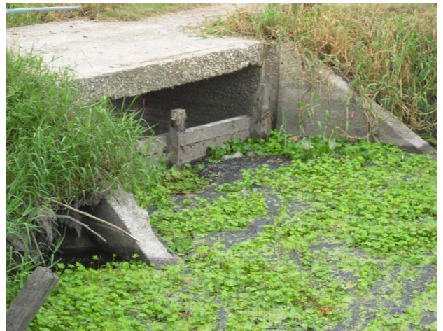
ภาพที่ 28 ประตูละบายน้ำปลายคลองระบาย 1 ฝั่ง ซ้ายคลองเจดีย์บูชา
