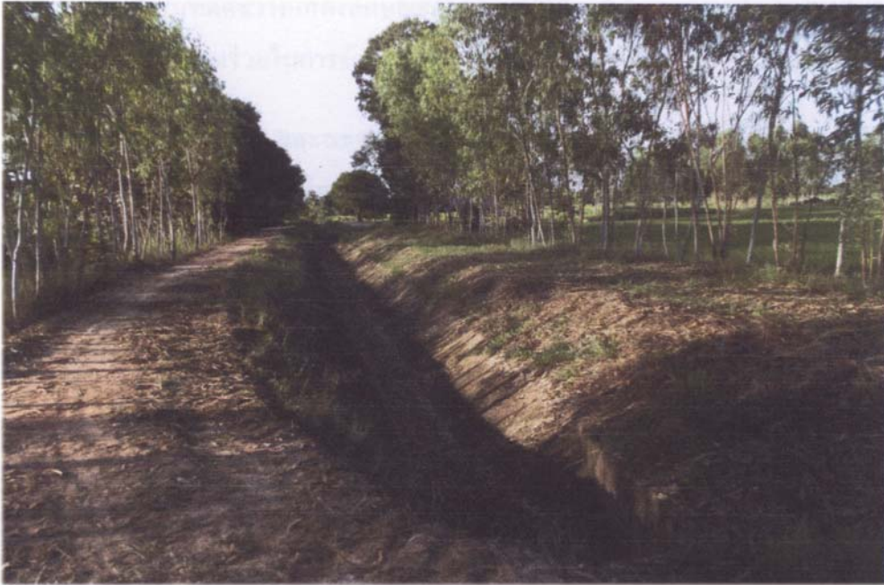
ภาพที่ 4.22 คลองชลประทานที่ถูกสร้างขึ้นมีการยกระดับสูงกว่าพื้นดินเดิมทำให้เกิดขวางทางน้ำไหล
