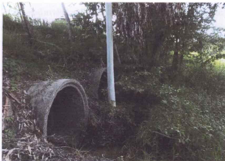
ภาพที่ 4.25 ท่อลอดใต้ถนนสายกมลาไสย – ร่องคำ เพื่อทำเป็นทางระบายน้ำที่ไหลมาจากทางทิศของตำบลโพนงาม
