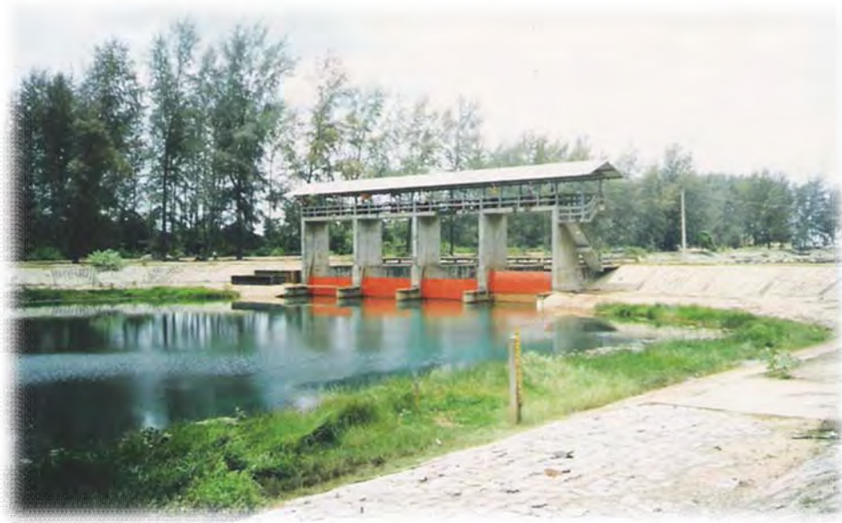
ประตูระบายน้ำน้ำแบ่ง
