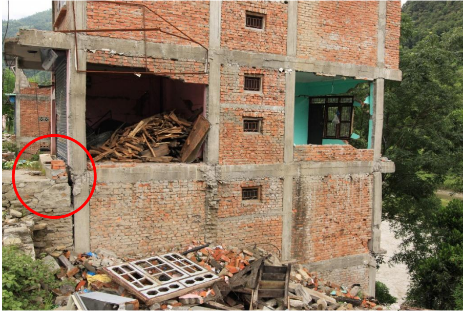
รูปที่ 52 ภาพความเสียหายของเสาด้านลาดเขา (ขวามือ) อันเนื่องมาจากพฤติกรรมการค้ำยันด้วยแรงอัดจากกำแพงอิฐก่อ ในเขต Lamosangh ความเสียหายที่พบหลักๆมีสองจุด คือเสาด้านหน้าอาคาร (ทางซ้ายมือ) ที่เกิดความเสียหายจากแรงเฉือน อีกจุดหนึ่งอยู่ด้านลาดเขา ที่ไม่มีพื้นดินช่วยต้านทานแรงด้านข้าง
