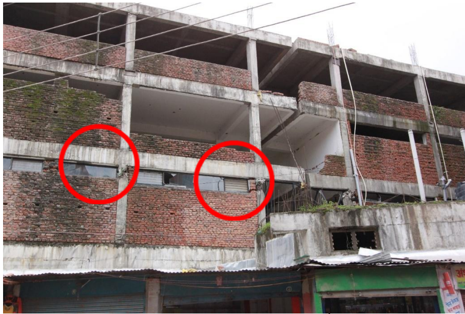
รูปที่ 37 การวิบัติเนื่องจากช่องเปิดของกำแพงอิฐก่อ ทำให้เกิดลักษณะเสาสั้น ซึ่งทำให้เสาคอนกรีตวิบัติจากแรงเฉือน การวิบัติในเสาสั้นเคยเกิดขึ้นที่โรงเรียนแม่ลาววิทยาคม ในเหตุการณ์แผ่นดินไหวที่จังหวัดเชียงราย เมื่อปี 2557 เกิดจากการทำช่องหน้าต่างและช่องแสงที่เหนือกำแพงที่ก่อทับ เสาที่อยู่ในระดับเดียวกับช่องเปิดเรียกว่า “เสาสั้น” จะเกิดการวิบัติแบบเฉือน รอยแตกเป็นแนวทแยงและจะสูญเสียกำลังรับน้ำหนักแนวดิ่งเพราะส่วนบนจะไถลลงมาแล้วถูกผลักออกด้านข้าง ดังรูปที่ 38
