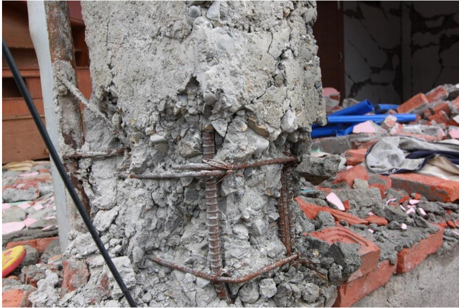
รูปที่ 32 สภาพคอนกรีตหลังการวิบัติที่เป็นลักษณะของการแยกตัวของหินและซีเมนต์ในบริเวณผิวของหิน
