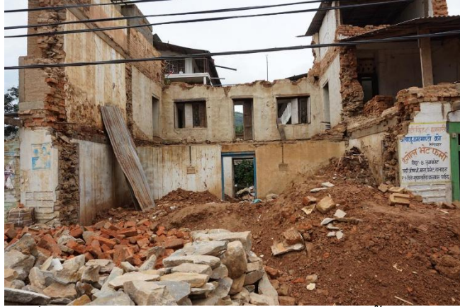
รูปที่ 90 ลักษณะความเสียหายของอาคารแบบดั้งเดิมประเภทอิฐก่อ
