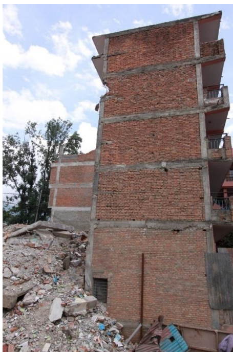
รูปที่ 43 ภาพความเสียหายของเสาบริเวณชั้น 4 อันเนื่องจากการถูกกระแทกโดยอาคารข้างเคียงที่เกิดการถล่มในเขต Sithapaila
