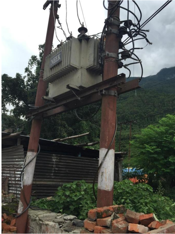
รูปที่ 82 หม้อแปลงไฟฟ้าที่ตั้งอยู่บนเสาได้รับการยึดรั้งไม่ให้ตกลงมา
