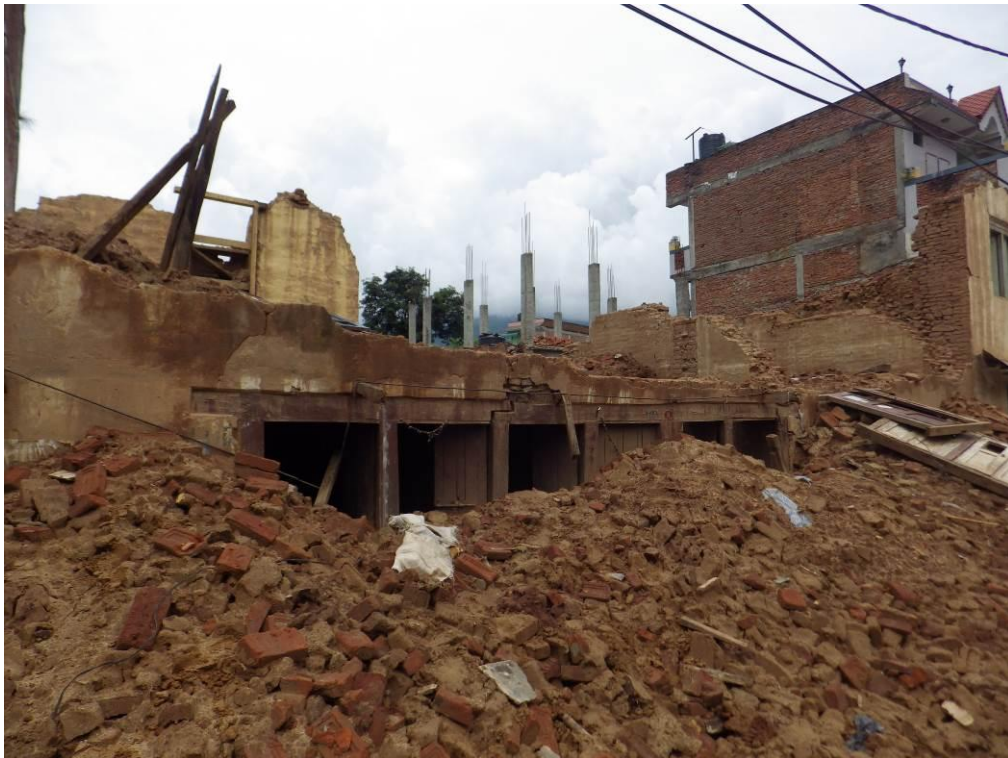
รูปที่ 6 การวิบัติของอาคารประเภทอิฐก่อ
