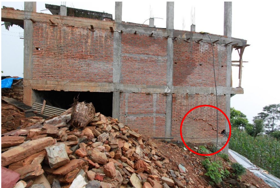
รูปที่ 53 ภาพความเสียหายของเสาด้านลาดเขา (ขวามือ) อันเนื่องมาจากพฤติกรรมการค้ำยันด้วยแรงอัดจากกำแพงอิฐก่อ ในเขต Sangachok
