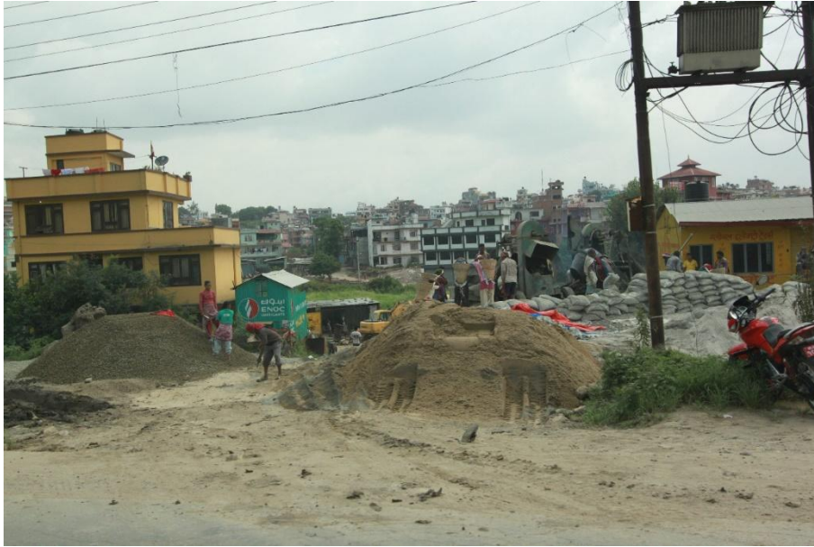
รูปที่ 30 การผสมคอนกรีตที่ทำบริเวณหน้างานก่อสร้าง ไม่มีการตวงวัดปริมาณมวลรวมที่เหมาะสม และไม่มีการเก็บปูนซีเมนต์ในที่ร่ม
