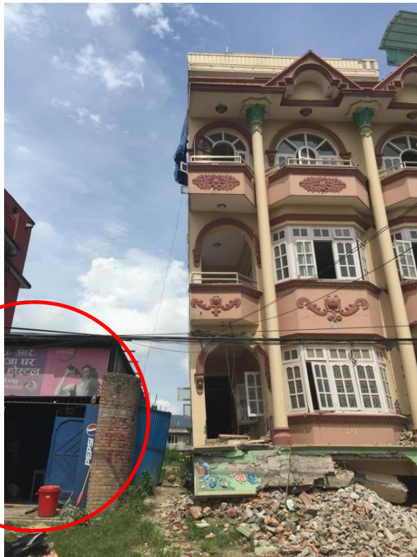
รูปที่ 57 ร้านอาหารที่มีเสี่ยงจากอาคาร 4 ชั้นข้างเคียงจะล้มมาทับเนื่องจากชั้นล่างที่อ่อนแอได้วิบัติไปแล้ว
