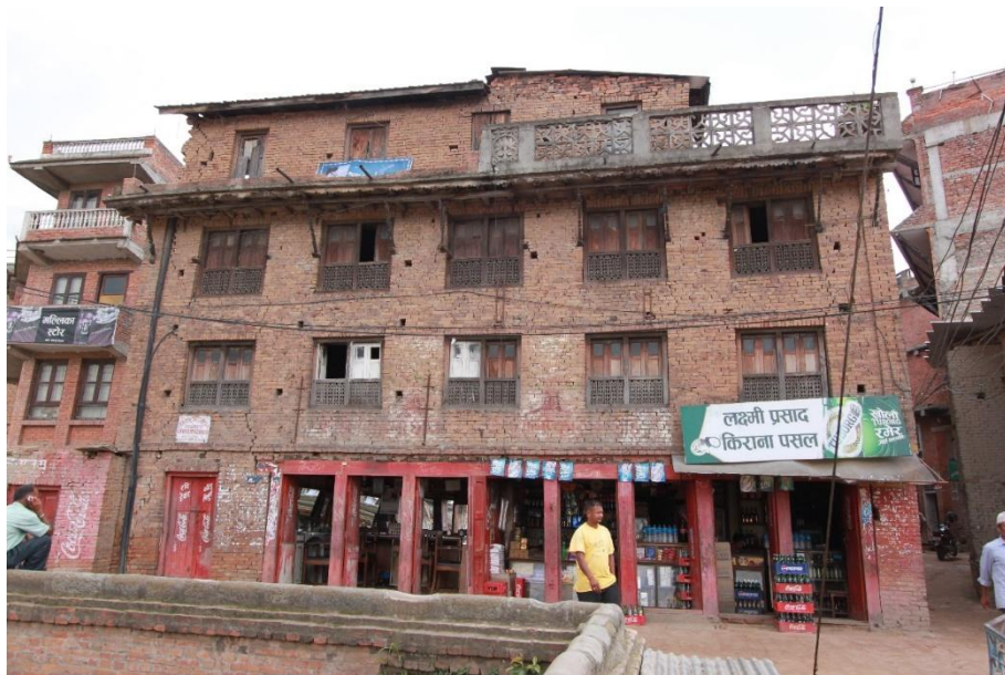
รูปที่ 28 การวิบัติที่เกิดขึ้นในระนาบกำแพง โดยสามารถสังเกตได้จากรอยแตกระหว่างก้อนอิฐที่กระจายอยู่ทั่วอาคาร
