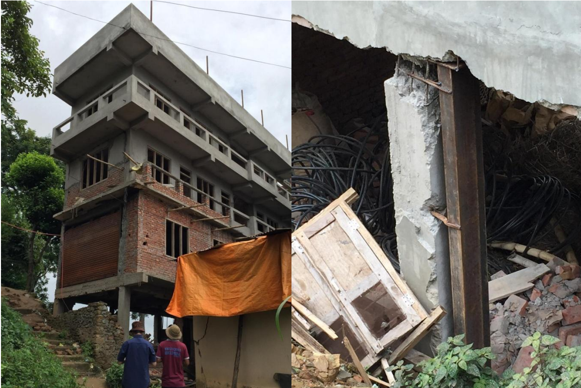
รูปที่ 60 อาคาร คสล. 4 ชั้นหลังหนึ่งในเมือง Chautara มีความเสียหายรุนแรงที่เสา เจ้าของอาคารจึงใช้เหล็ก รูปพรรณ H200 ค้ำยันไว้ไม่ให้อาคารถล่มลงมา
