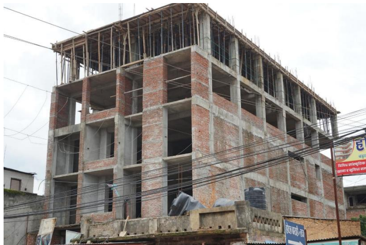
รูปที่ 91 ลักษณะอาคารสมัยใหม่ก่อสร้างด้วยคอนกรีตเสริมเหล็ก ในภาพรวมมีความเสียหายน้อยกว่าอาคารแบบดั้งเดิม
