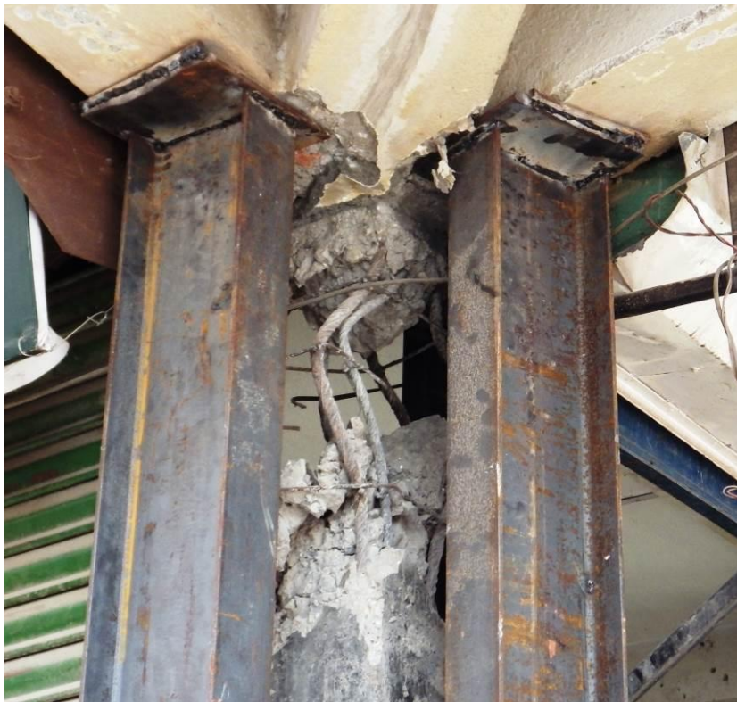
รูปที่ 3 ลักษณะการวิบัติของเสาจากการเสริมเหล็กไม่เพียงพอ
