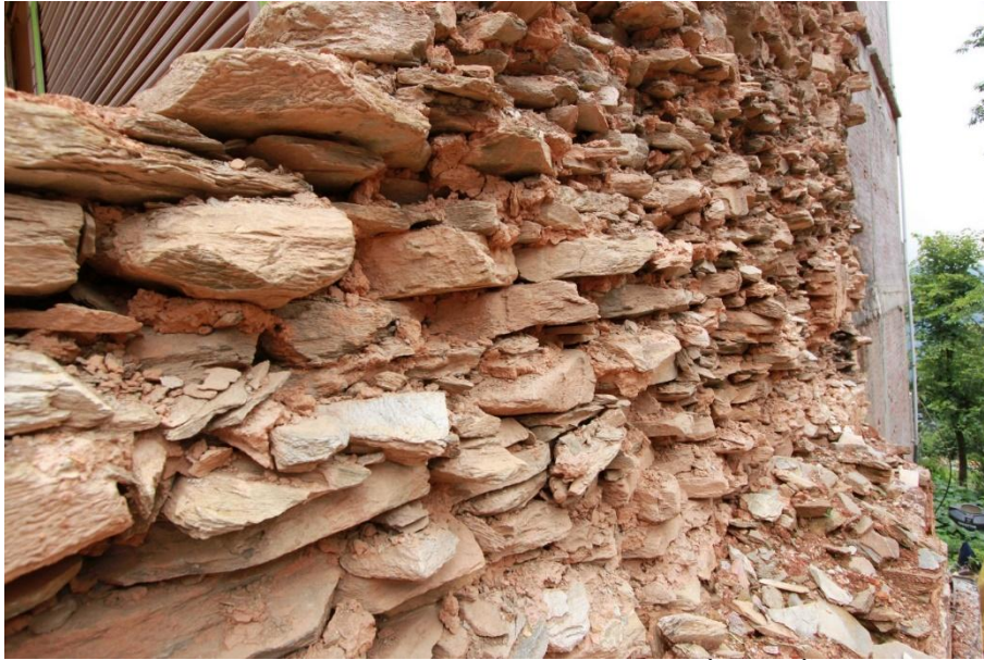
รูปที่ 22 การวิบัติออกนอกกระนาบของกำแพงหินก่อรับแรงแบบที่มีการแยกชั้น โดยชั้นที่ก่อทางขวามือได้ถล่มลงไป แต่ชั้นซึ่งอยู่ทางด้านซ้ายมือยังคงตั้งอยู่
