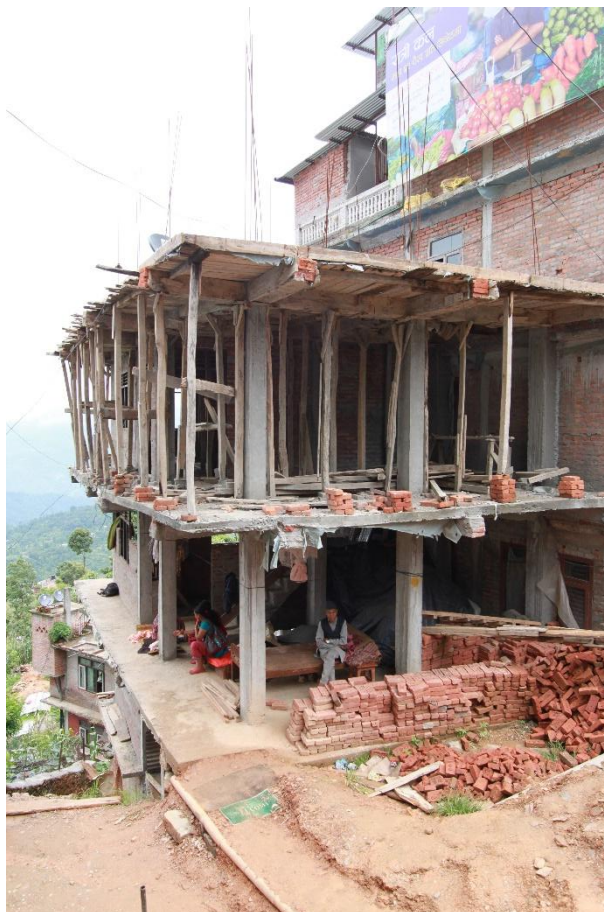
รูปที่ 33 การเข้าแบบหล่อคอนกรีตที่ไม่ได้มาตรฐาน รวมถึงการเทคอนกรีตที่ไม่มีการควบคุมคุณภาพ
