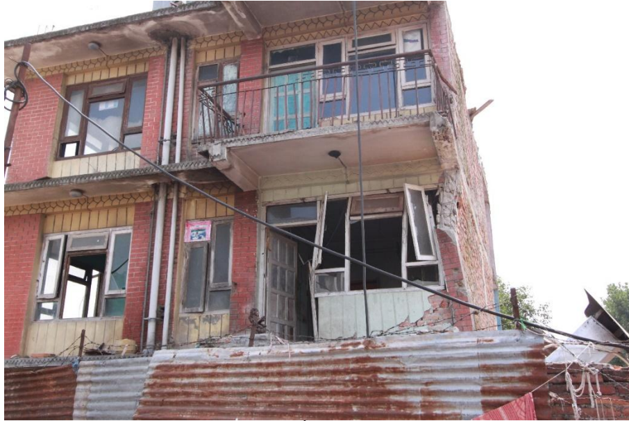
รูปที่ 44 ความเสียหายเฉพาะที่ของโครงสร้างเสาบริเวณชั้นสองที่ถูกกระแทกโดยอาคารข้างเคียง ในเขต Sithapaila
