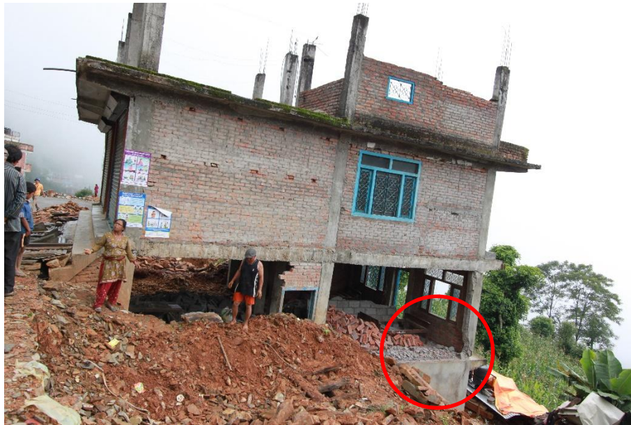
รูปที่ 54 ภาพความเสียหายของเสาด้านลาดเขา (ขวามือ) อันเนื่องมาจากพฤติกรรมการค้ำยันด้วยแรงอัดจากกำแพงอิฐก่อ (ในรูป กำแพงอิฐได้ถูกรื้อถอนออกไปแล้ว) ในเขต Sangachok
