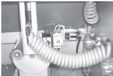
รูปที่ 8 อุปกรณ์ท่อลมลดขนาดในการสร้างแรงดันลมขณะกำจัดฝุ่นละอองของกรองอากาศแบบแบน
