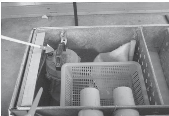
รูปที่ 7 ปั้มน้ำไดโว่และถังกรองน้ำบำบัดเศษกากใย
