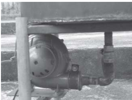
รูปที่ 2 เครื่องเป่าอากาศ
