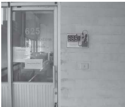
รูปที่ 8 ตำแหน่งที่ติดตั้ง อุปกรณ์แจ้งเตือน เมื่อผู้ป่วยมีอาการไข้สูงแบบไร้สาย
