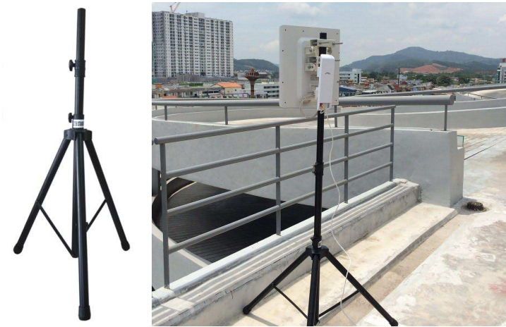
ภาพที่ 5 ชุดติดตั้งอุปกรณ์สื่อสาร
