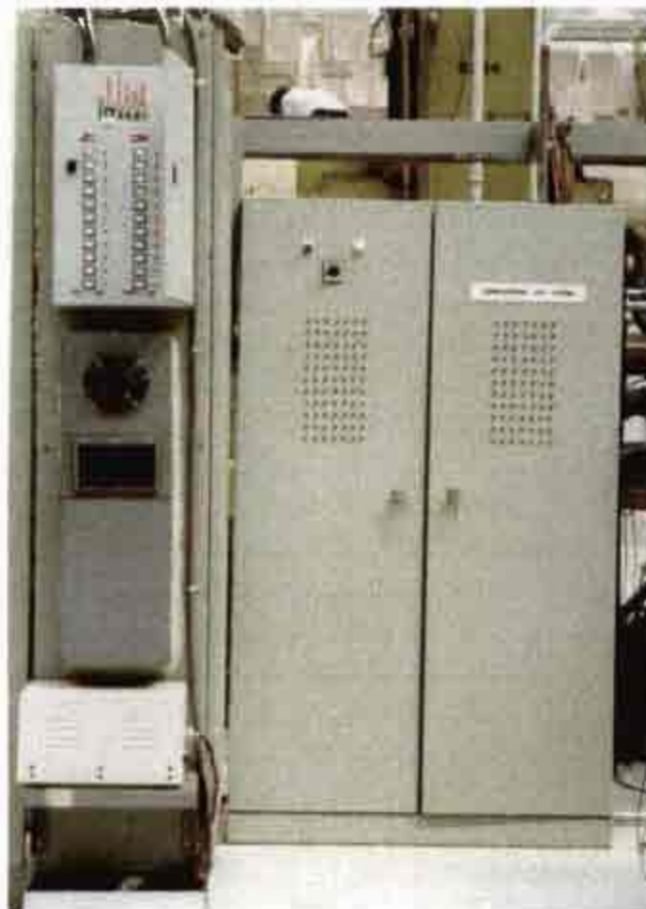
รูปที่ 6.5 ตู้ติดตั้ง Solidstate Relay
