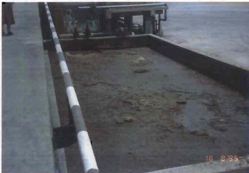
ภาพที่ 4.6 ระบบกำจัดฝุ่นละออง : ไฮโดรอนตักฝุ่น (ภาพบน) การกำจัดด้วยน้ำ ( ภาพล่าง)
