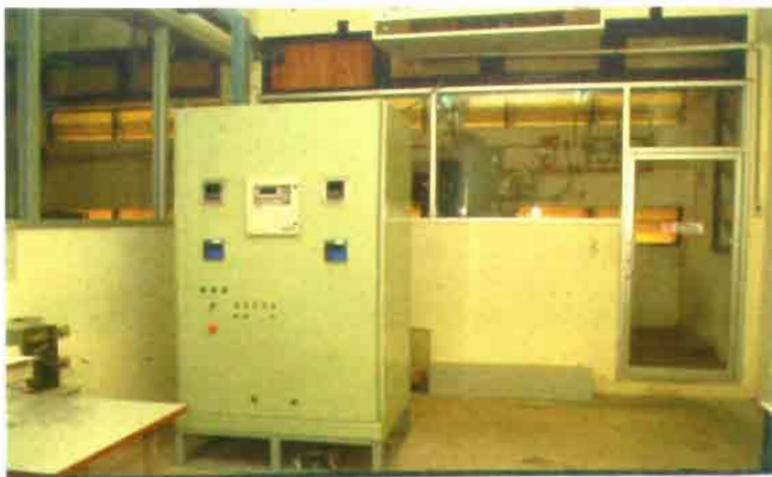
รูปที่ 4.9 ตู้ควบคุมการที่งานของระบบเผาแก๊ส
