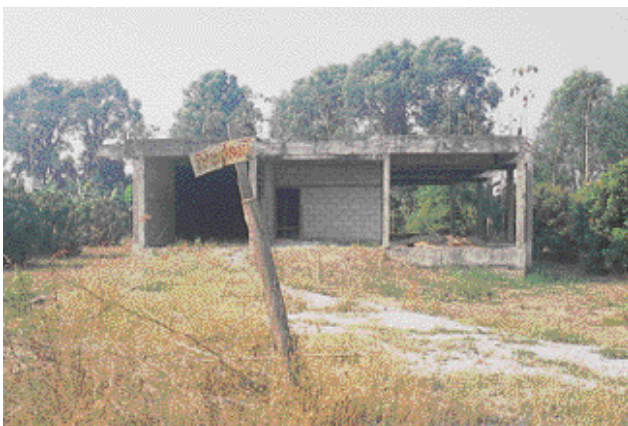
บ้านจัดสรร ที่สร้างไม่เสร็จและไม่ได้สร้างต่อ
