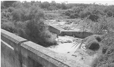
ทำนบพังเพียง 2-3 ปีหลังจากก่อสร้างเสร็จลง ชาวบ้านยังไม่ได้เริ่มใช้น้ำจากทำนบนี้มาก่อนเลย
