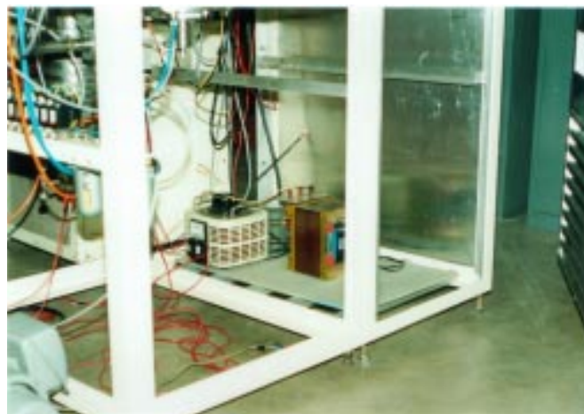
รูปที่ 3.21 หม้อแปลงไฟฟ้าของระบบจ่ายไฟฟ้าแรงสูงของเครื่องเคลือบ
