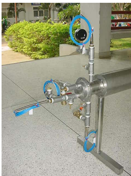
ภาพผนวกที่ ข6 การติดตั้งอุปกรณ์วัดอัตราการไหล ความดัน และอุณหภูมิ สำหรับเครื่องแลกเปลี่ยนความร้อน
