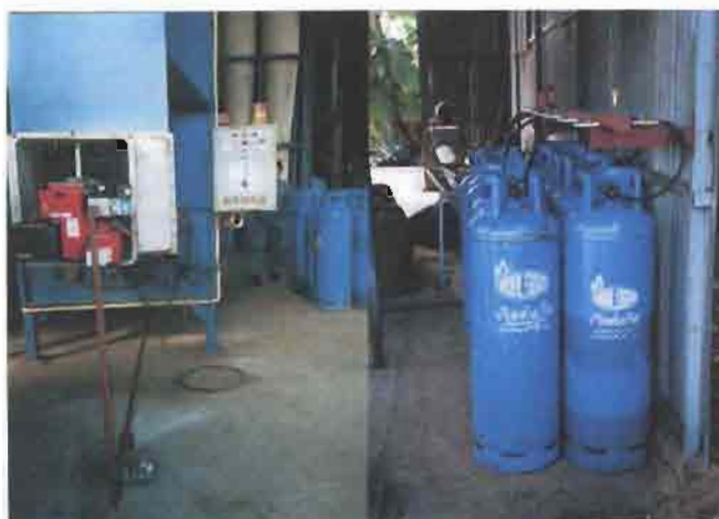
ภาพที่ 15 สถานีเก็บและจ่ายก๊าซ LPG
