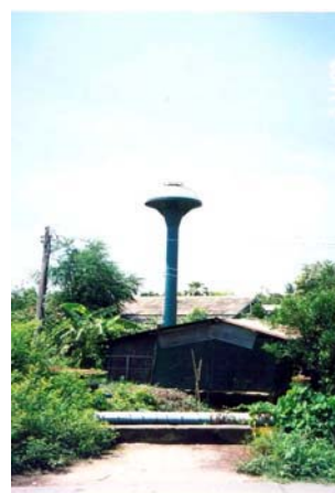
บ่อน้ำบาดาลของชุมชนแผ่นดินทองคอยรุตต์กัว
