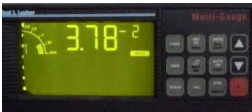
รูปที่ 6.9 ค่าความดันที่วัดได้จาก Convectron Gauge ที่ติดตั้งบริเวณ Backing Valve
