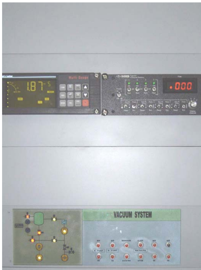
รูปที่ 6.18 แสดงส่วนของตู้ควบคุมขณะทำการสร้างความดันก่อนเคลือบ
