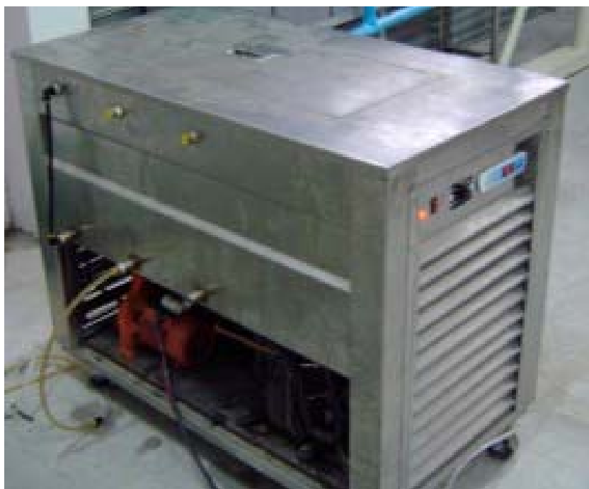
รูปที่ 5.21 ระบบน้ำหล่อเย็น
