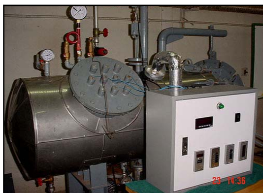
Fig. 3.2 Actual equipment setup.
