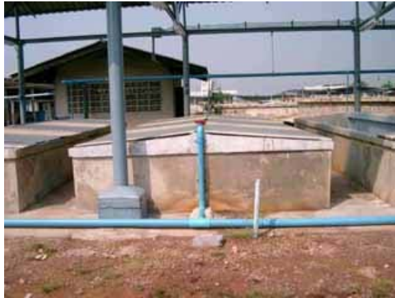
รูปที่ 1 บ่อคอนกรีตที่ใช้อุณหภูมิสูงในการบำบัดน้ำ
