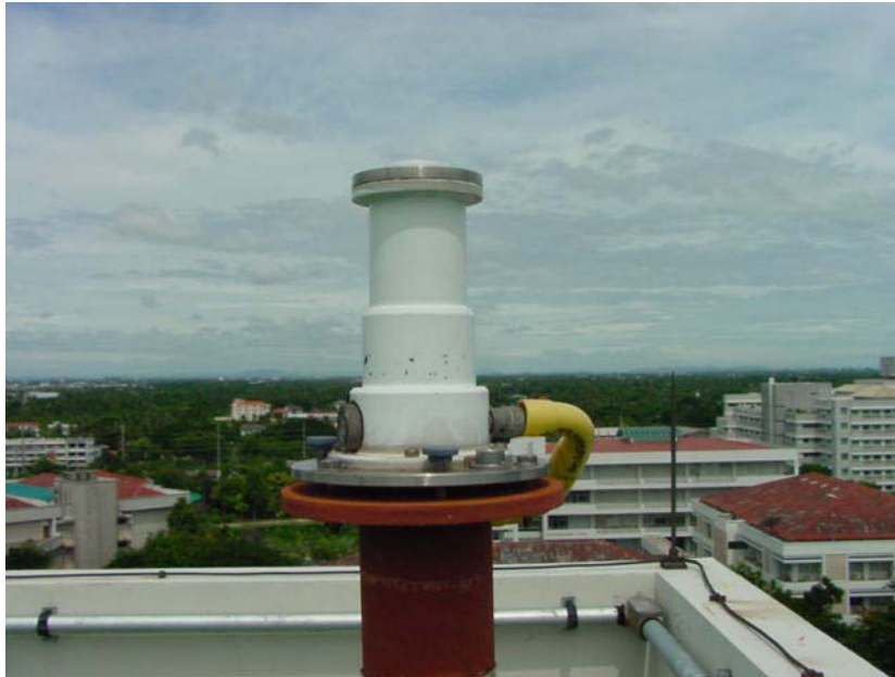
รูปที่ 3.72 แสดงเครื่องวัด TUV ซึ่งติดตั้งอยู่ที่คานฟ้าของอาคารวิทยาศาสตร์ 1 คณะวิทยาศาสตร์ มหาวิทยาลัยศิลปากร จังหวัดนครปฐม
