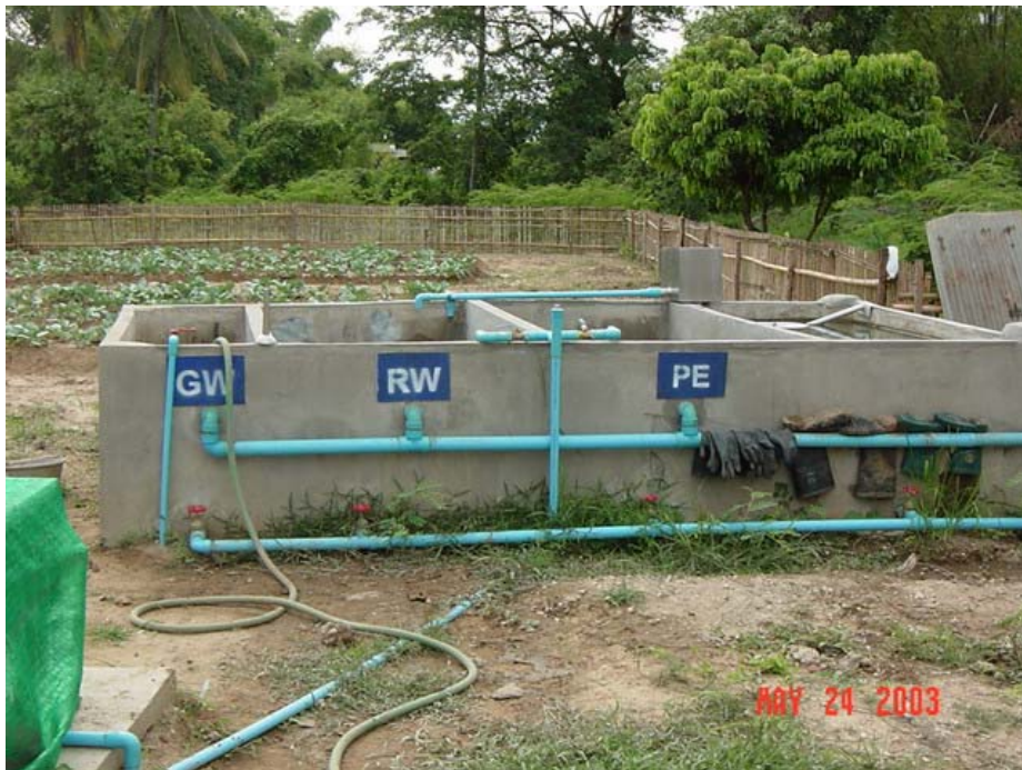
ข. ถังตกตะกอนขั้นต้นและถังเก็บน้ำ
