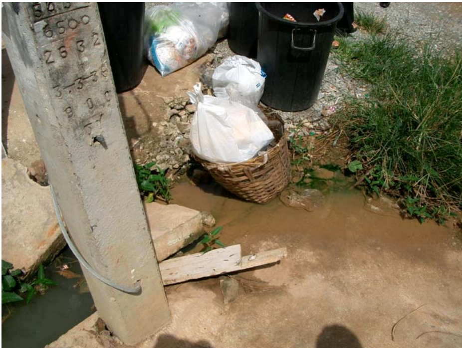
รูปภาพที่ 6.11 น้ำเสียล้นจากท่อระบายน้ำ
