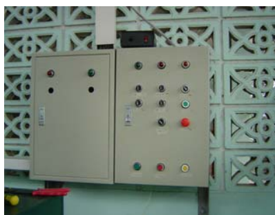
ภาพที่ 5.4 กล่องระบบควบคุมอัตโนมัติ
