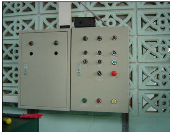
ภาพที่ 3.14 กล่องระบบควบคุมอัตโนมัติ
