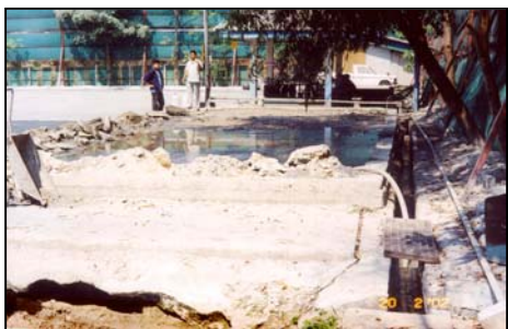
ภาพที่ 4.1 บ่อคายกากคอนกรีต
