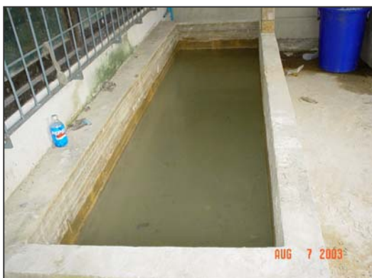
ภาพที่ จ.20 บ่อพักน้ำสลัดจ์
