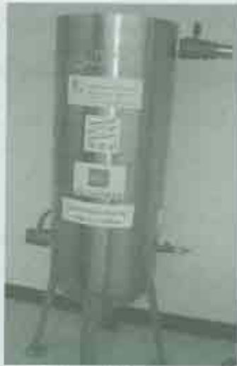
ถังบำบัดน้ำเสีย
