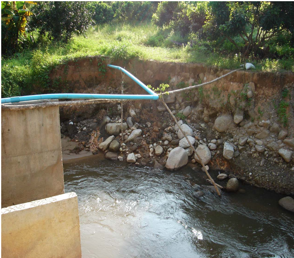
ภาพที่ 33 ฝ่ายหลวงคอนกรีตแม่น้ำพัง จากน้ำป่าที่ไหลทะลักลงมาอย่างรุนแรงในช่วงกลางปี 2548
