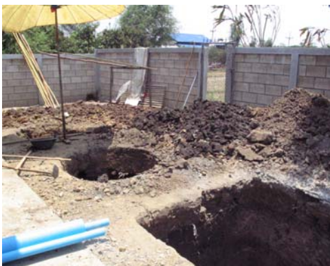
รูปที่ ก. 4 บ่อน้ำบาดน้ำเสีย
