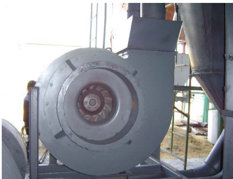
รูปที่ ค.7 แสดงพัดลมที่ใช้ในการจ่ายอากาศผสมกับก๊าซร้อนเพื่อลดอุณหภูมิ
