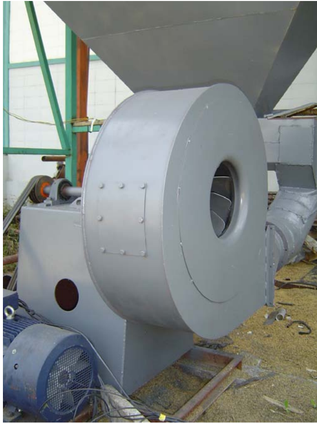
รูปที่ ค.2 พัดลมอากาศส่วนที่ 1 ที่จ่ายเข้าที่ด้านบนของเตาเผาไหม้ในแนวสัมผัสพร้อมทั้งเกลบ
