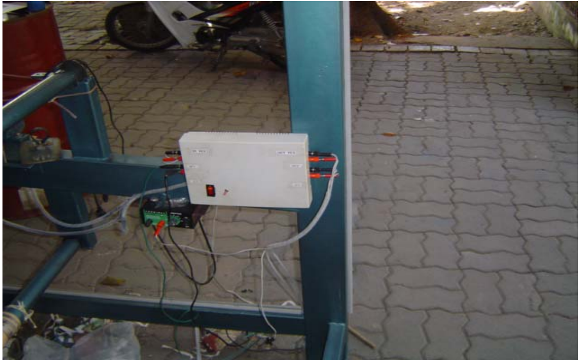
รูป ง - 5 แสดงภาพกล่องควบคุมไมโครคอนโทรลเลอร์
