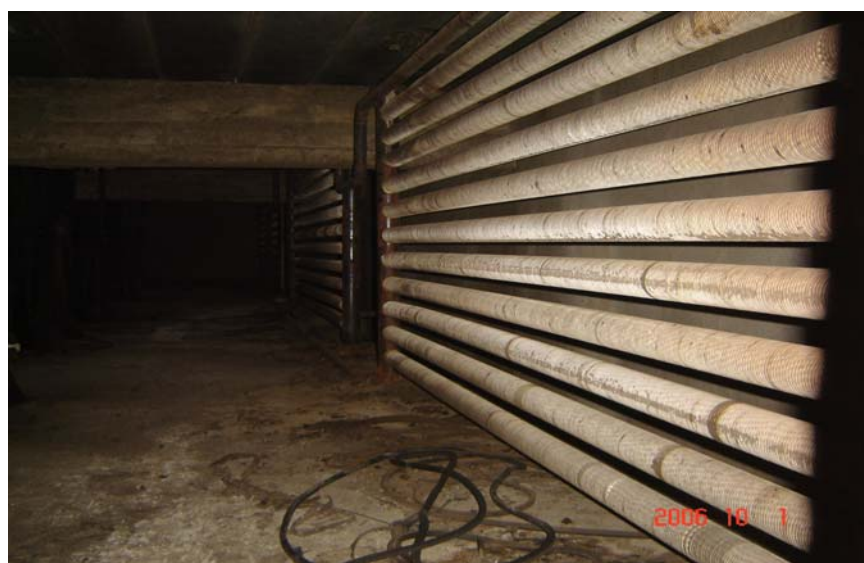
ภาพที่ 7.13 ลักษณะของคอยล์ให้ความร้อน
